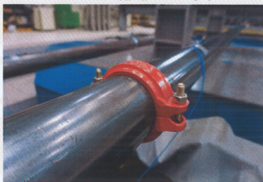
Photo B.7 시험 전 UUT-1 그루브조인트
